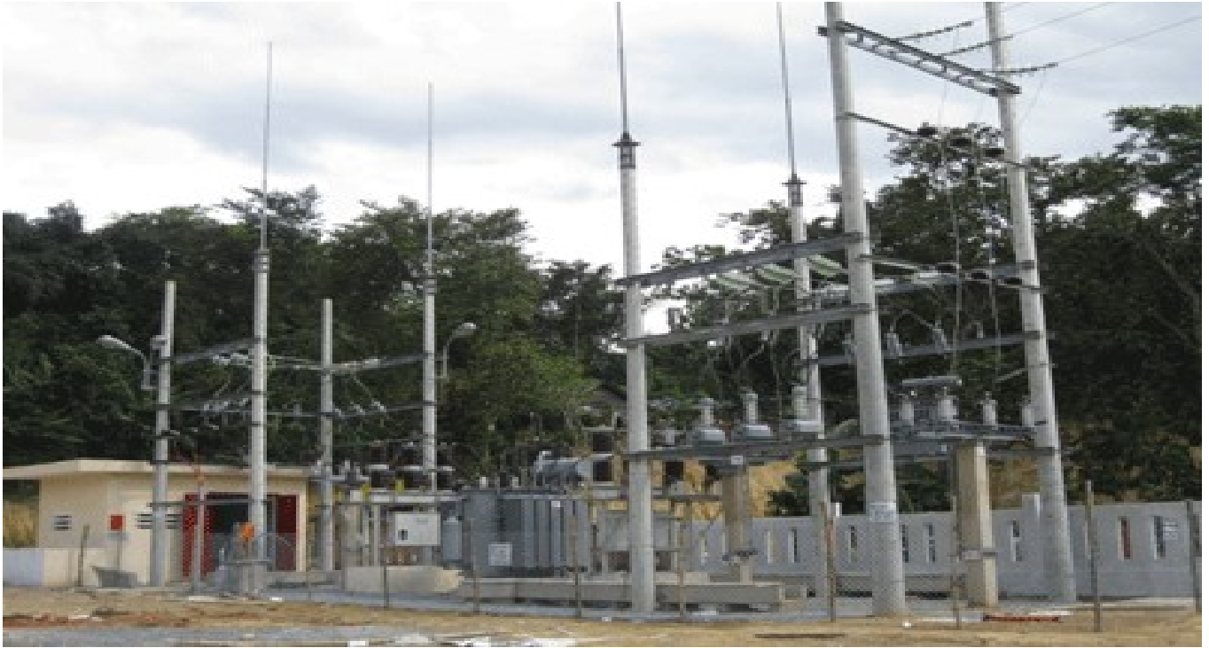
Рисунок 1.20 – Промежуточная трансформаторная станция подает электроэнергию общинам Дак-Мил и Дак-Глун
