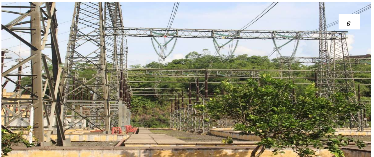
Рисунок 4.14 – Фотографии трансформаторной подстанции мощностью 500 кВт с масляными трансформаторами Хоа-Бинь района Хоа-Бинь: a – в зоне 1; б – в зоне 2; в – в зоне 3
