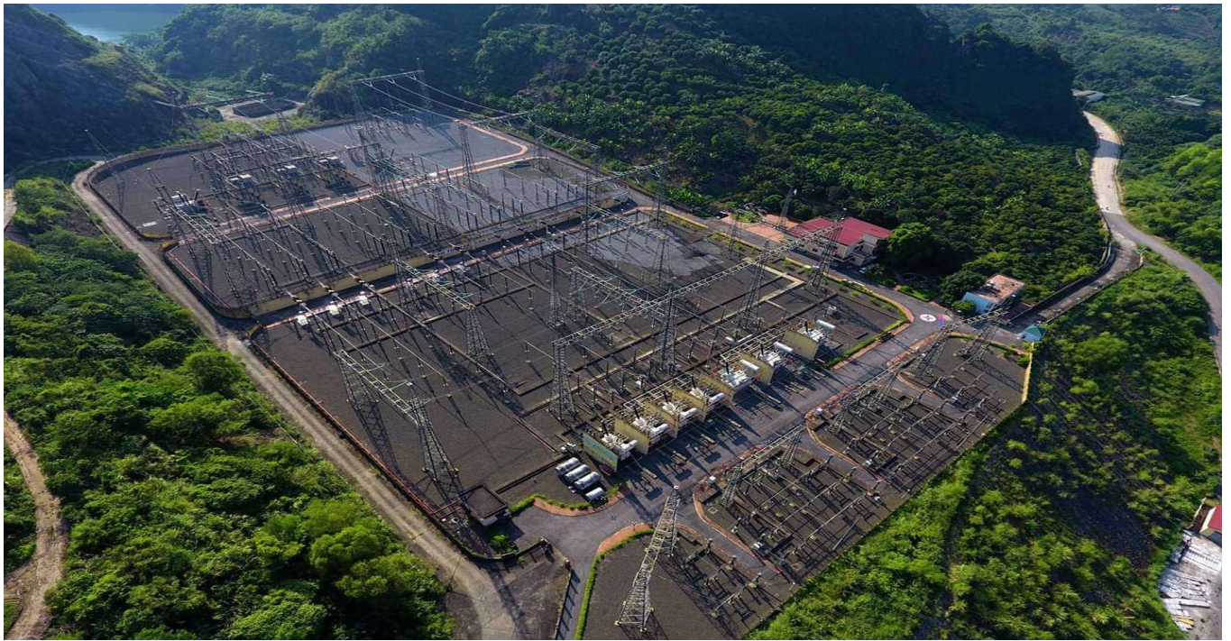
Рисунок 4.13 – Ландшафтный вид трансформаторной подстанции мощностью 500 кВт с масляными трансформаторами Хоа-Бинь района Хоа-Бинь
