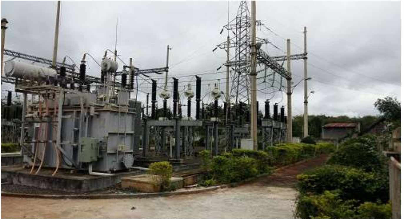
Рисунок 1.19 – Трансформаторы 220/110/35кВ на станции Плейку
