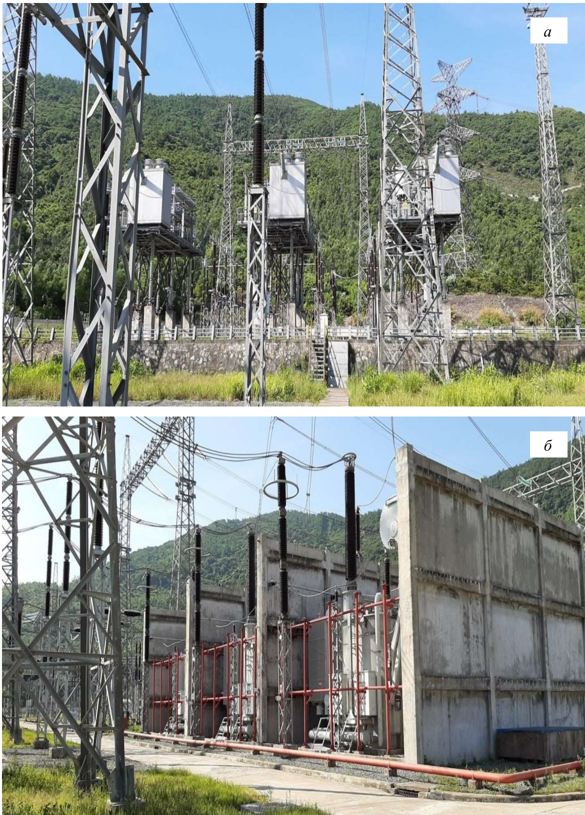
Рисунок 4.8 – Фотографии трансформаторной подстанции мощностью 500 кВт с масляными трансформаторами Вунг-Анг района Ха-Тинь: а – в зоне 1; б – в зоне 2
